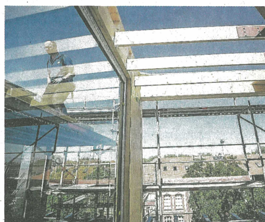
Erste Fenster wurden bereits eingebaut, durch die die Bewohner auf Düsseldorf blicken können.
